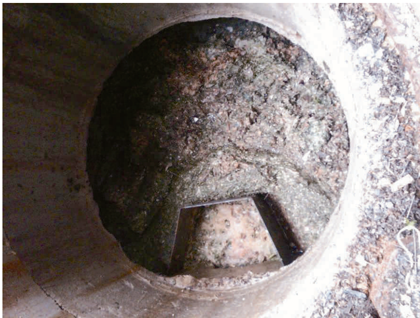
入口付近に廃棄物が集中的に堆積したスラリー槽のマンホール
