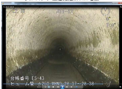
②平成4年設置ヒューム管250 DSP41戸、圧送距離290m圧送後
