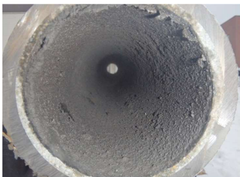
①平成4年設置DIP100圧送管 DSP11戸、圧送距離2.5km地点
